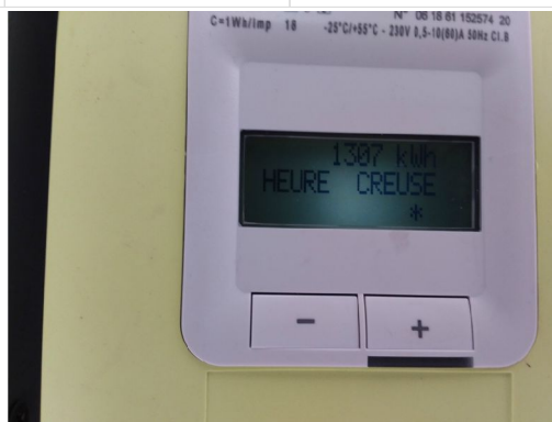
Compteur d'électricité HC
