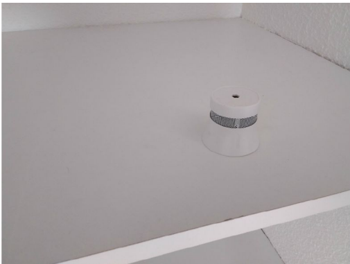
Détecteur de fumée
