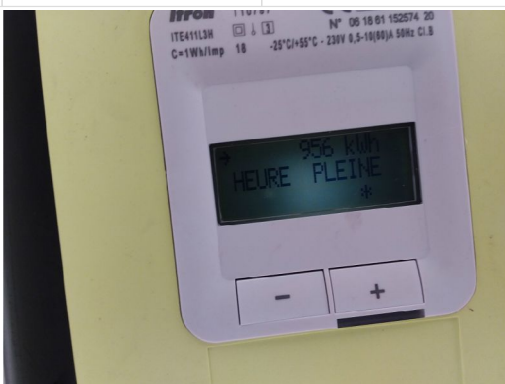
Compteur d'électricité HP
